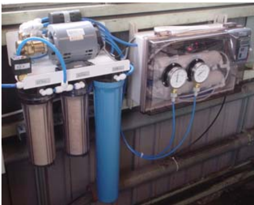
和歌山 岡シャーリング(株) 2トン/日 冷却装置のスライム除去目的
