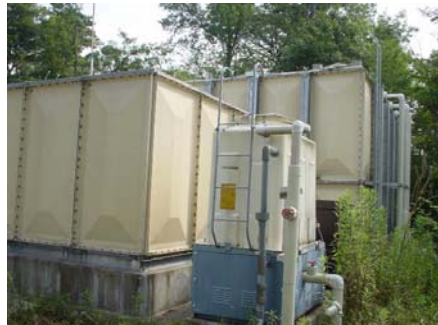
■設置例(貯水タンクと処理装置の外観)
